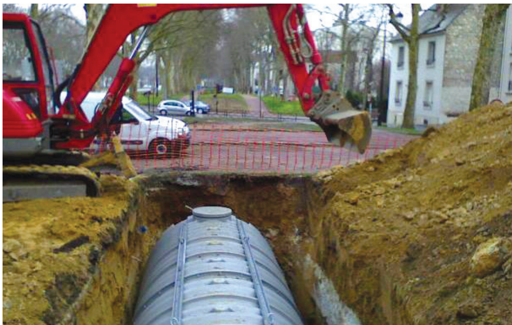
Bâche de rétention d'eau souterraine, avenue de Paris
